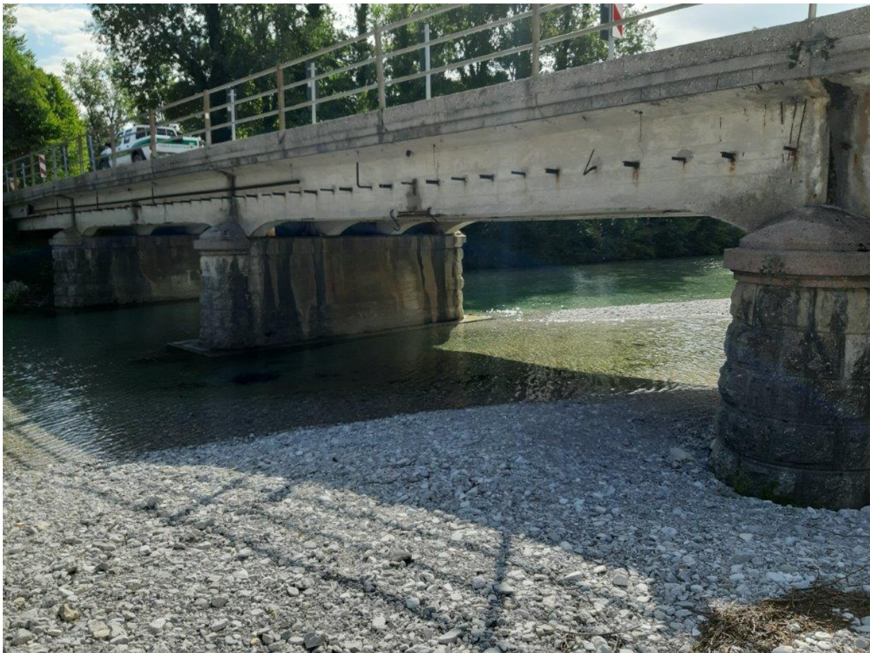
Immagine del ponte da demolire della s.r. UD 41 "di Forgaria" sul torrente Leale
